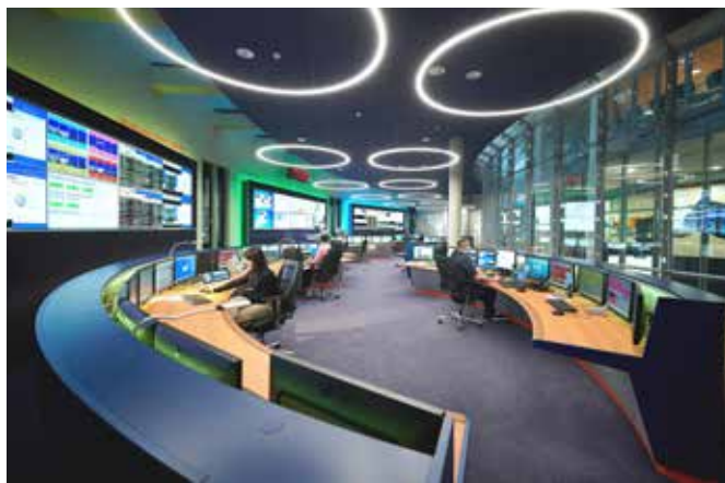
Haute précision et primées: les nouvelles consoles du GEO Mission Control Center.
